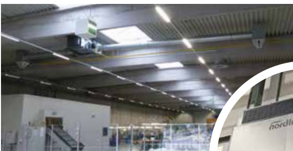
Logistikzentrum für Flugzeugteile: decken- hängende Anlage mit 4-seitigen Ausblasköpfen.
