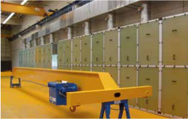
Lackierhalle: Zuluftanlage inkl. Abluft-Filterwand (Konstant-Zuluft-Temperaturregelung).
