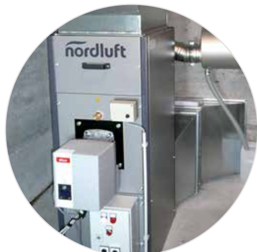
Frischlufthanschluss eines NL-A WO
