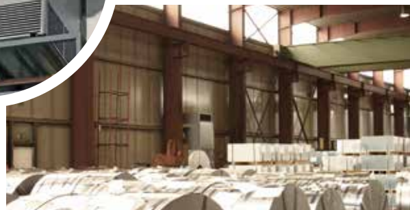
Metall-Coillager: Permanent-Beheizung zur Verhinderung von Rostbildung.
