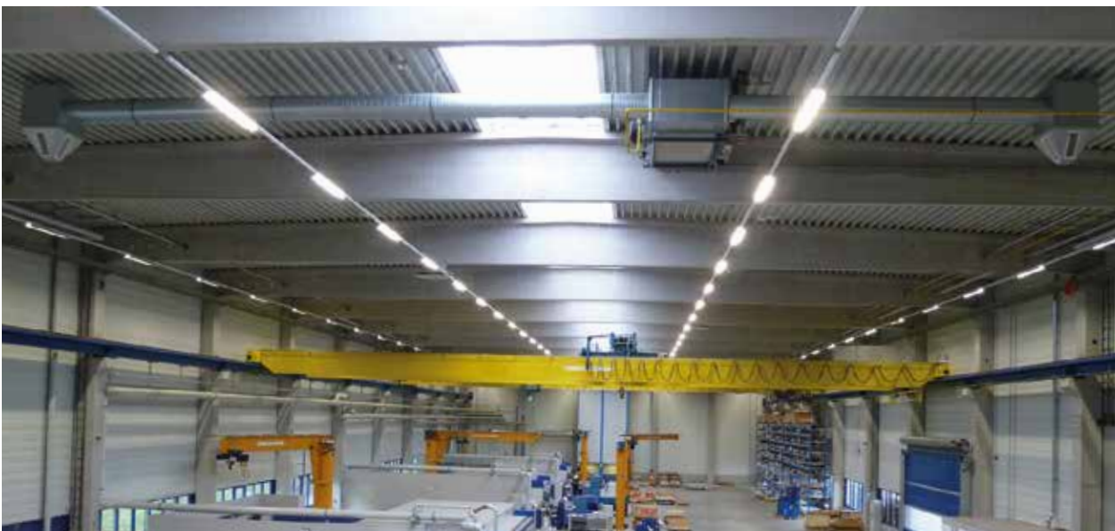
Feinmechanikproduktion: Beheizung mit Weitwurf-Ausblasköpfen. Wärmerückführung mittels Deckenventilatoren.
