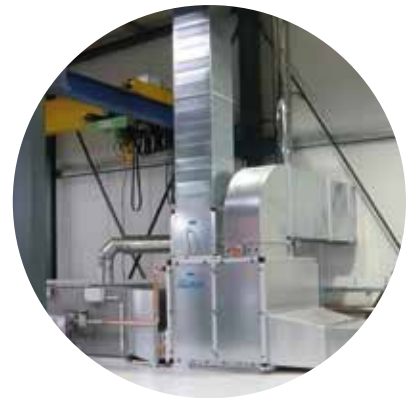
Trockentunnel: Lieferung NL-A, Abluft, Wärmerückgewinnung, Steuerung/Regelung.
