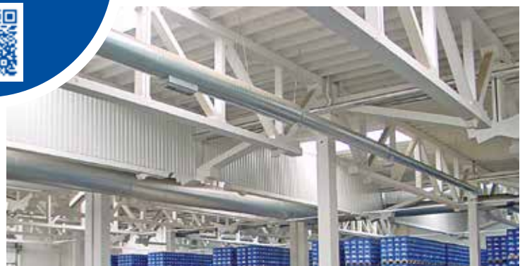
Brauerei-Logistikhalle: Permanent-Beheizung und -Belüftung (Dauerlüftungsbetrieb).
