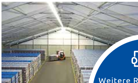
Logistik-Zelt f. Getränke (40 x 110 m): Luftverteilung über 4 Anlagen durch Weitwurfdüsen für 60 m Wurfweite.
