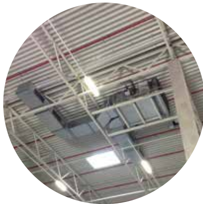
NL-A Deckengerät mit Ansaug-Filter und Zuluftkanal.
