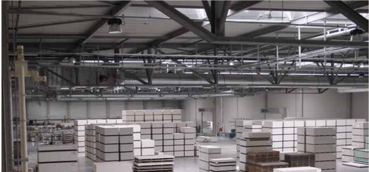
Rigipslager: Beheizung mit optionaler Frischluftbeimischung.
