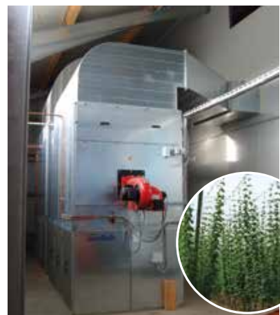
Hopfentrocknung: 1 x NL 900 und 1 x NL 1100 in Rahmenbauweise.
