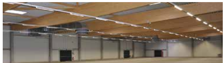
Messehallen: Beheizung / Belüftung (Dauerlüftungsbetrieb), Weitwurfdüsenkopf.
