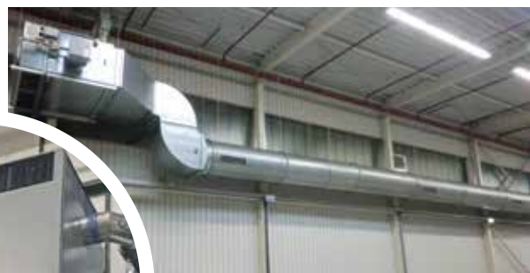
Papierlager: Beheizung mit zusätzlicher Schleierung Schleusenbereiche zwischen Lager und Produktion.
