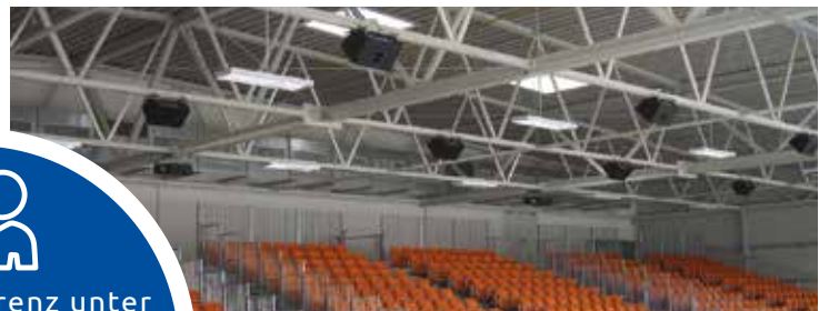
Auktionshalle: Permanent-Beheizung und -Belüftung (Dauerlüftungsbetrieb).
